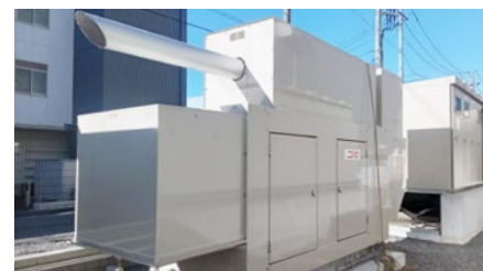
■ 非常用発電機
